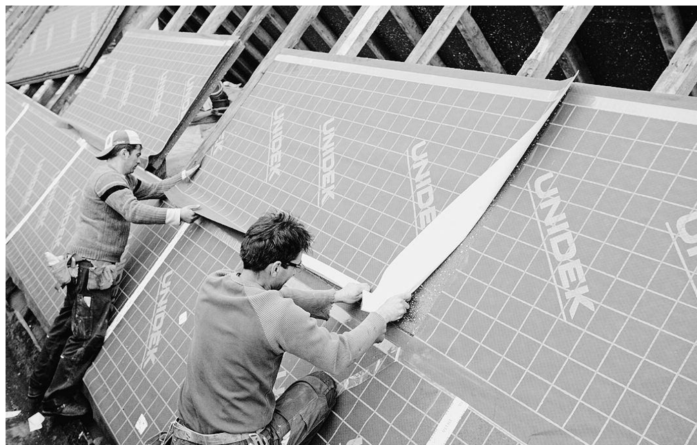
Schnell ins Trockene: Aufsparrendämmungen schaffen schnell eine neue warme Dachhülle. Foto: Kingspan Unidek
